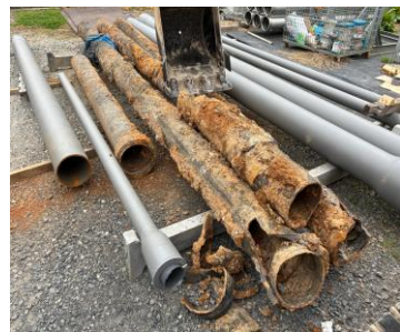
老朽管の状況（昭和34年布設）
