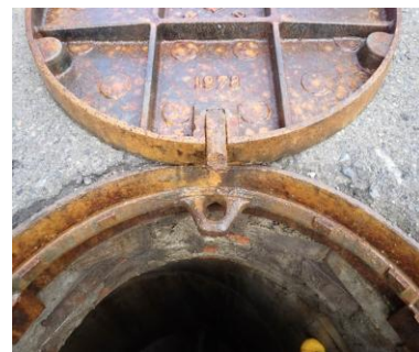
劣化したマンホール蓋
