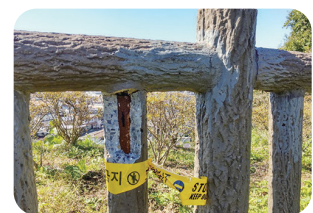
柵の損傷の様子
