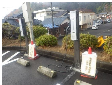
EV 充電スタンド
