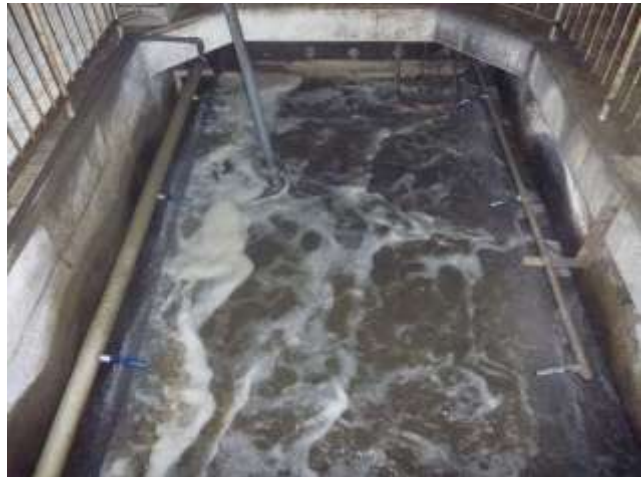
■ エアレーションタンク
