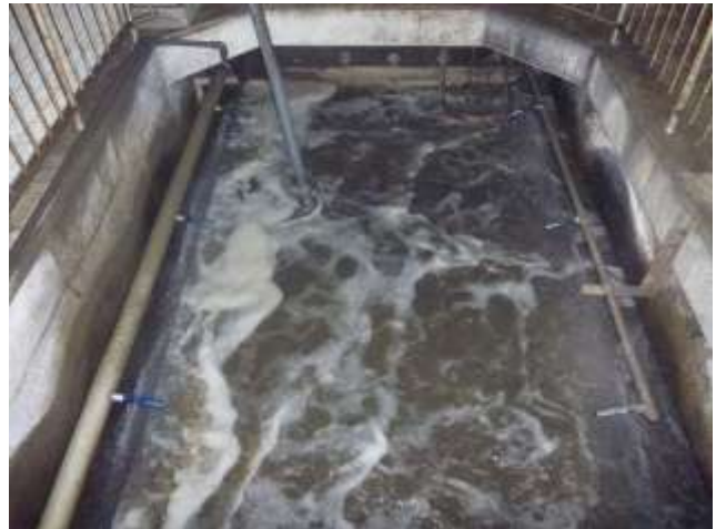
■ エアレーションタンク
