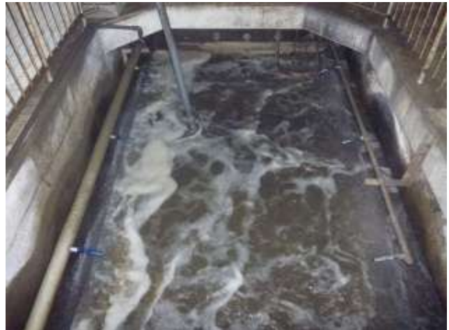
■ エアレーションタンク
