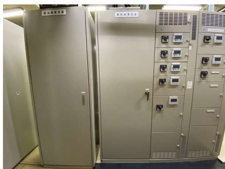
補助継電器盤 機能増設
